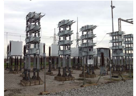
Kondenzatorska baterija, 110 kV, 3x16 Mvar CRNA GORA
