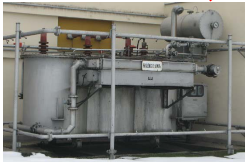
Prigušnica, 30 kV, 50 Mvar
