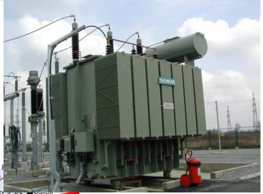
Prigušnica, 110 kV, 100 Mvar SRBIJA
