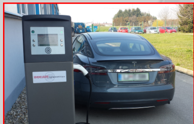
Instalacija prve punionice ispred Ducati komponenti d.o.o. u Ludbregu
